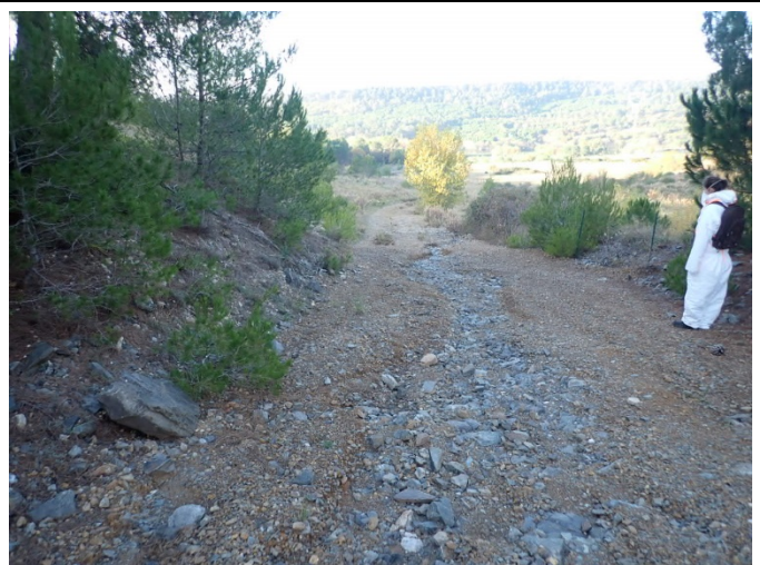
Illustration 27 : Passage dégradé de la piste d'accès Sud
