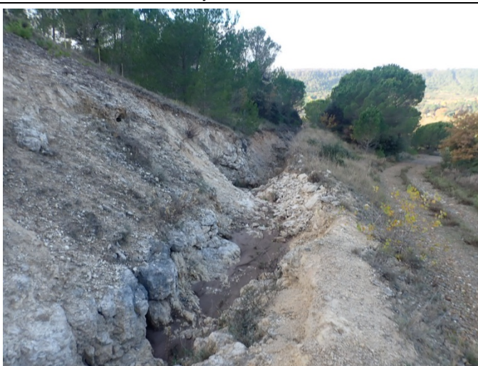
Illustration 35 : Fossé drainant Sud-Est, raviné
