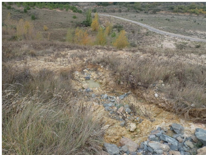
Illustration 7 : Zone de ravines en amont de la mare B2 et merlon de protection dégradé en amont de la mare B2
