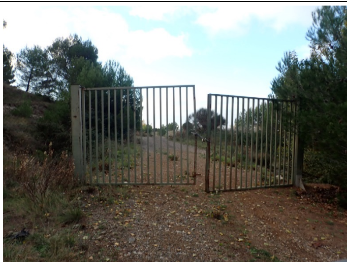
Illustration 25 : Portail d'accès au site de l'ARTUS, dégradé
