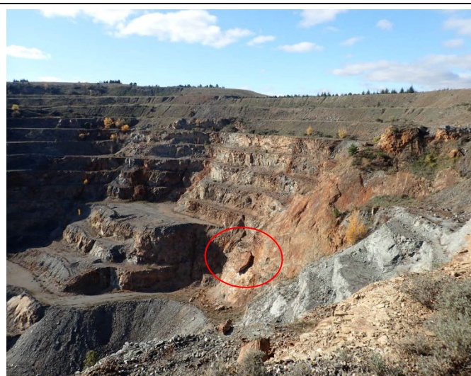
Illustration 44 : Bloc éboulé sur une paroi de la MCO
