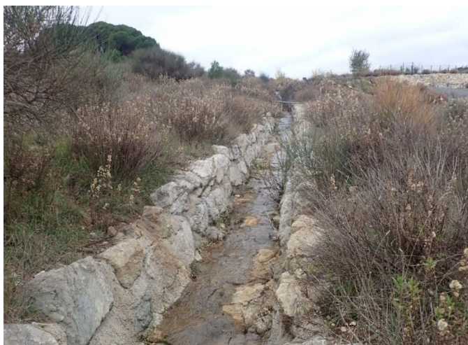
Illustration 17 : Caniveau d'acheminement des eaux pluviales en bon état de fonctionnement
