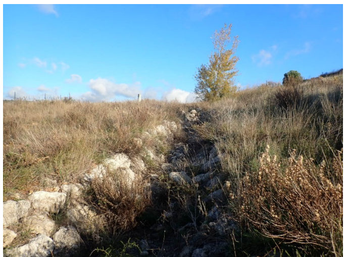
Illustration 29 : Caniveau de gestion des eaux encombré par la végétation
