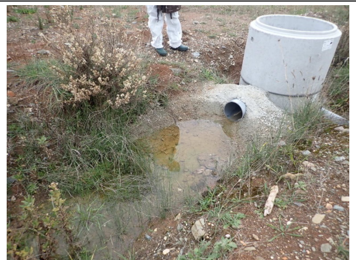
Illustration 24 : Avaloir bétonné de la source Arsine
