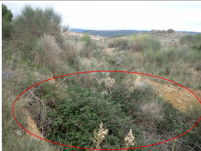
Illustration 11 : Caniveau d'amenée des eaux à la mare RM2, fortement raviné et comblé par la végétation
